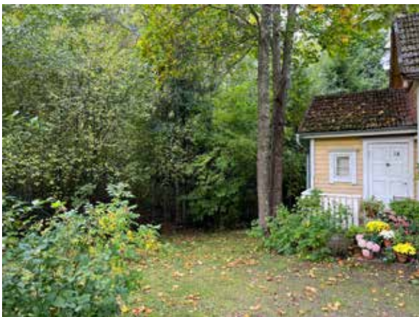
102. Aattolan eteläpuoleinen piha on hyvin varjoisa. Nurmikko on sammaleinen, ja myös talon eteläosan betonitiilikatto on sammalen peittämä. Aivan eteläpäädyn vieressä kasvava suuri, monihaaraainen vaahtera olisi syytä poistaa, jotta rakennuksen hoito ja säilyttäminen olisi helpompaa.
