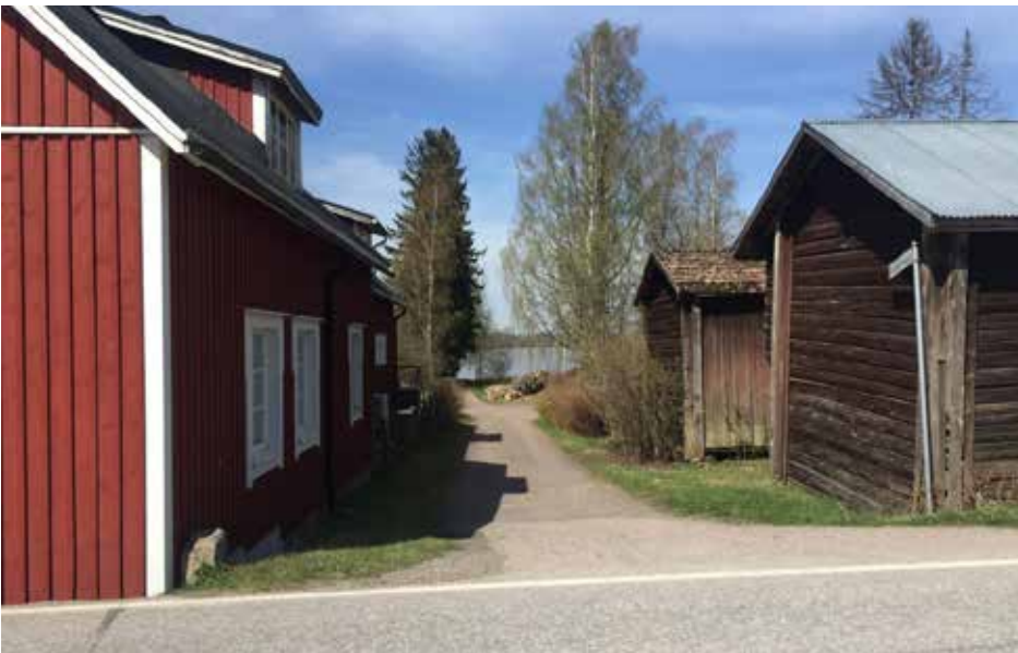
19. Saarelankuja Tuomalan kylässä Rantatien länsipuolella. Vasemmalla rakennuksen kivijalka on jäänyt kokonaan tien sisään. Myös oikeanpuoleinen aitta lahoaa tien pinnan nousun vuoksi. Samalla kujan liittyminen Rantatiehen on tullut jyrkäksi.
